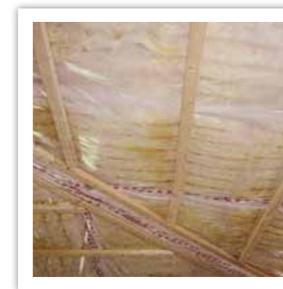
Acqua interna dovuta alla condensazione estiva.
